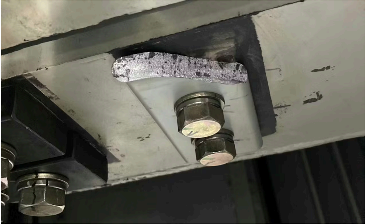
金属製の導体の付け根部分が断裂した=東電提供
